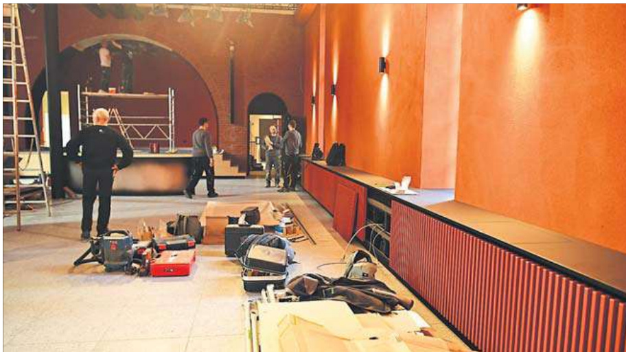
Bis kurz vor der Eröffnung am Donnerstagabend, wurde und wird auf der Baustelle noch eifrig gewerkelt.
